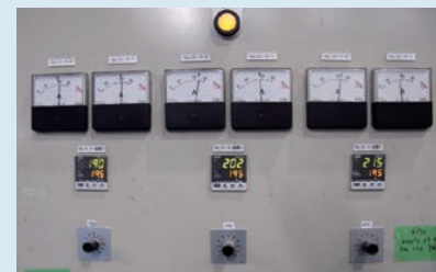
▲ ヒーター制御部
